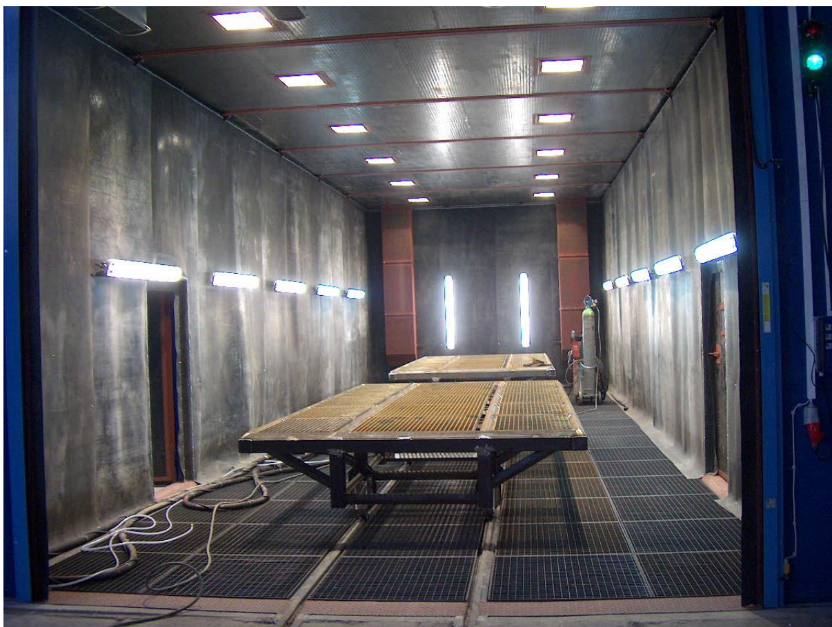
Rys. 10. Komora śrutownicza wraz z wózkiem technologicznym szynowym.
