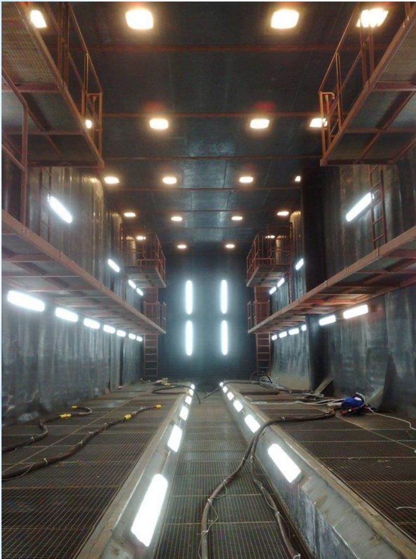
Komora śrutownicza wielkogabarytowa z torowiskiem, podestami i podłogą zgarniającą
